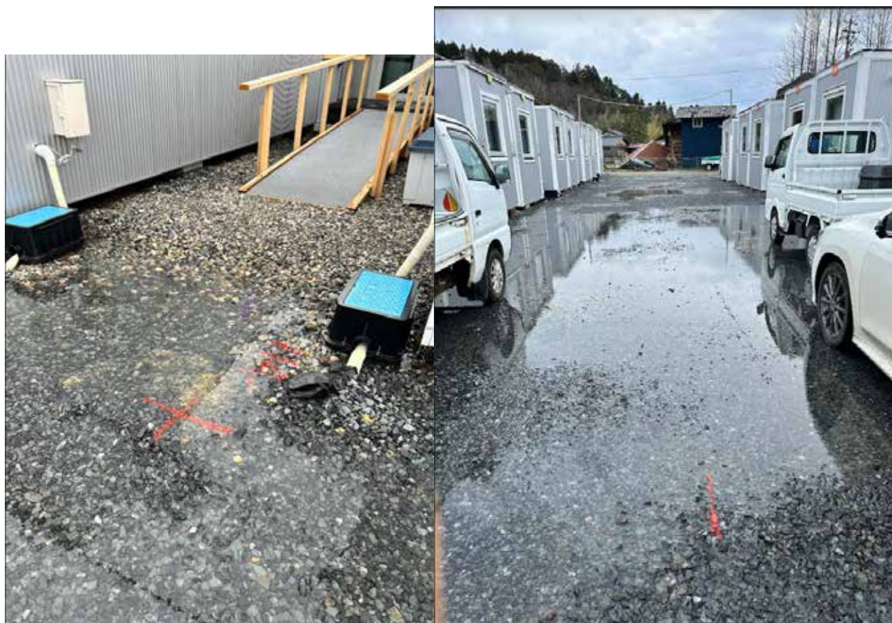
正院町 応急仮設住宅 雨天時の様子 ( 撮影：2024/3/21 )
