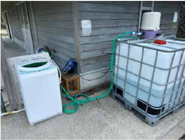
新たに設置した洗濯機
